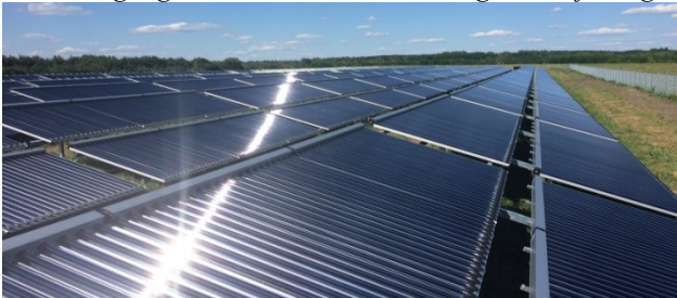
Abb. 1: Kollektorfeld für Fernwärme in Senftenberg
