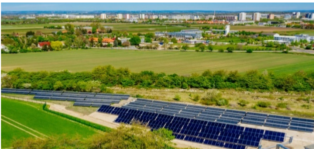
Abb. 6: Zwei Kollektorfelder für Fernwärme in Erfurt
