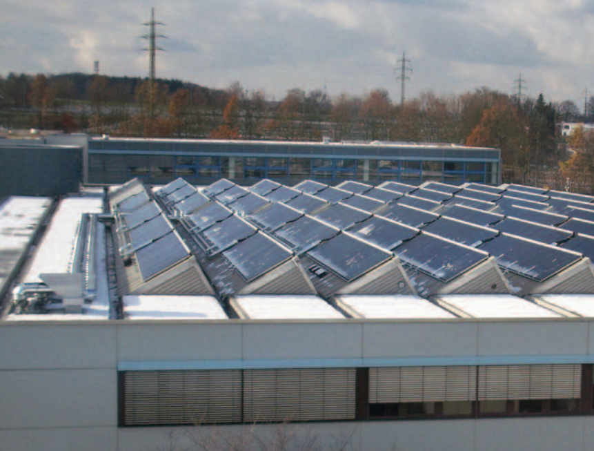
Solaranlagen für Heizung im Winter und Kühlung im Sommer in Esslingen und Istanbul mit nur ca. 10 Liter Speicher pro Quadratmeter Kollektorfläche und weit über 500 kWh pro Quadratmeter Systemertrag (2011)
