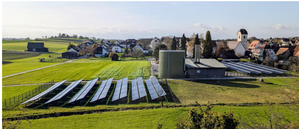
Blick auf die beiden Teilfelder der Solarthermieanlage in Breitenholz
