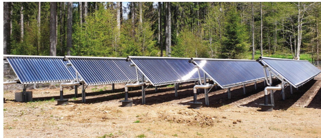
Das Kollektorfeld in Schluchsee
