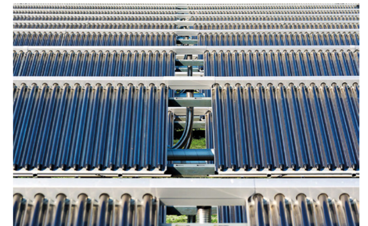
CPC-Vakuumröhrenkollektoren Ritter XL 19/49 | Foto: Guido Broer
