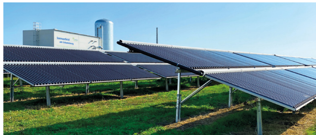
Kollektorfeld mit Wärmeübergabestation im Hintergrund
