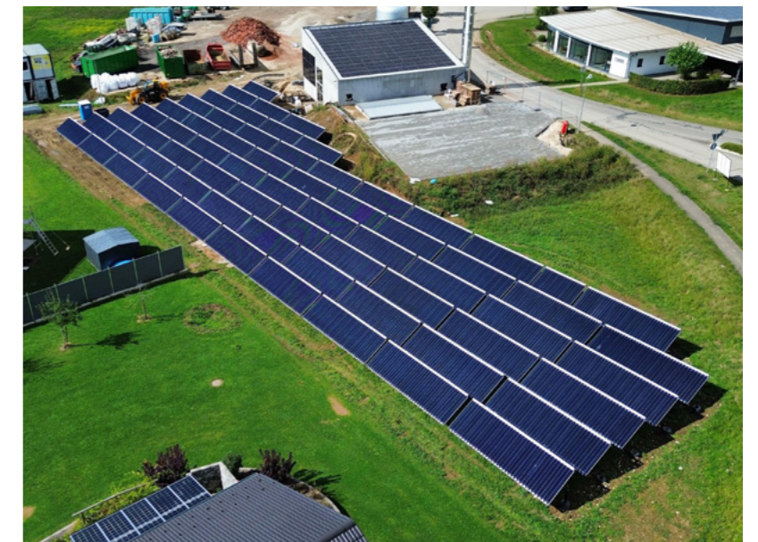
Das Kollektorfeld der Gemeinde Renquishausen
