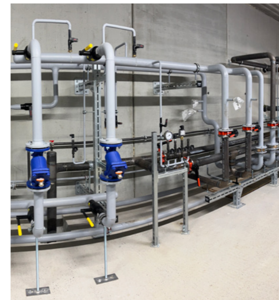
Heizhaus mit Technikzentrale
