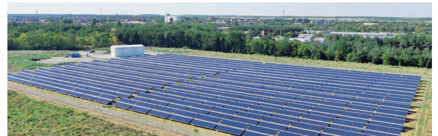
Das Kollektorfeld von Ritter XL Solar in Senftenberg
