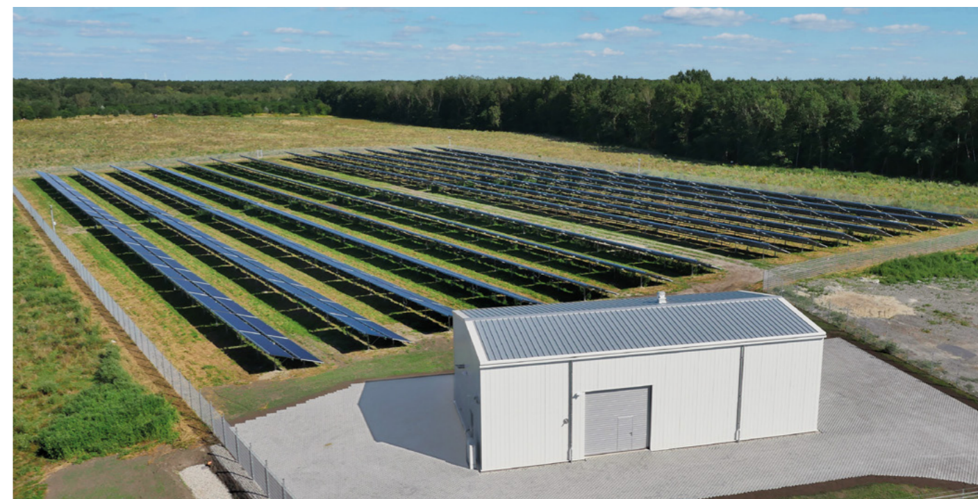
Kollektorfeld mit Fernwärmeübergabestation
