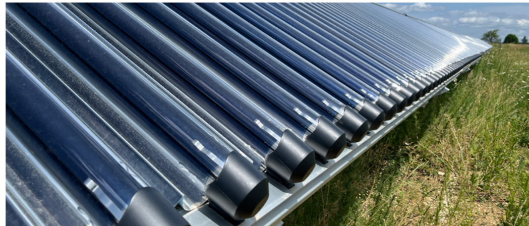
Kollektorfeld mit den neuen Großkollektoren „XXL 19/131“
