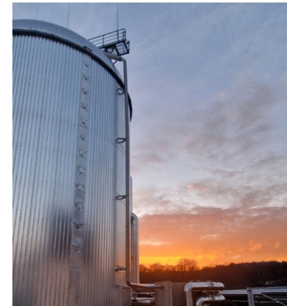
Der Wärmespeicher umfasst 1.250 m 3
