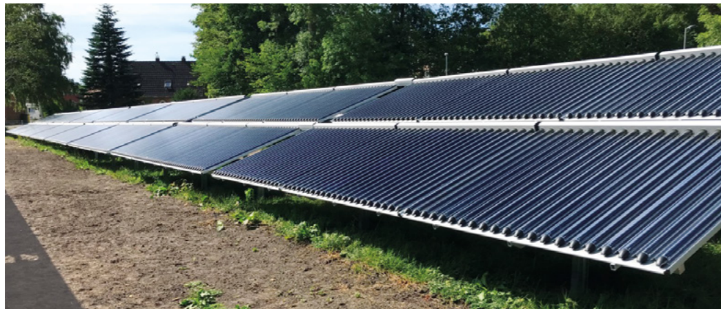
Kollektorfeld mit CPC Vakuumröhren-Kollektoren
