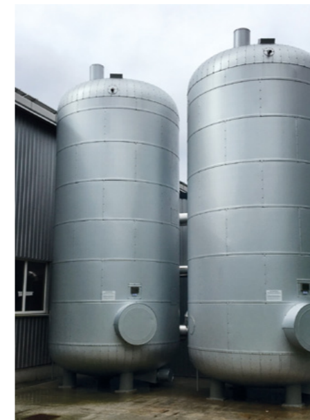
2 x 44 m 3 Pufferspeicher, Außenaufstellung
