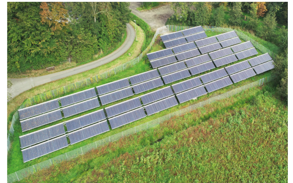
Das Kollektorfeld von oben
