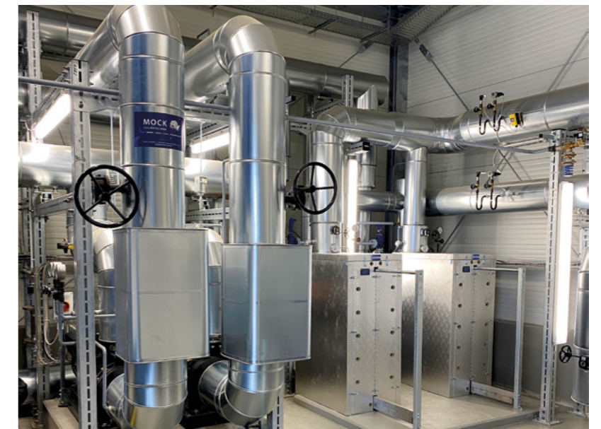
Redundante Wärmeaustauschereinheit für das Fernwärmenetz
