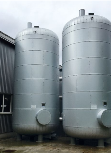
2 x 44 m³ Pufferspeicher, Außenaufstellung
