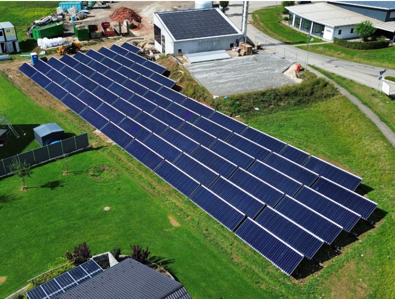
Das Kollektorfeld der Gemeinde Renquishausen
