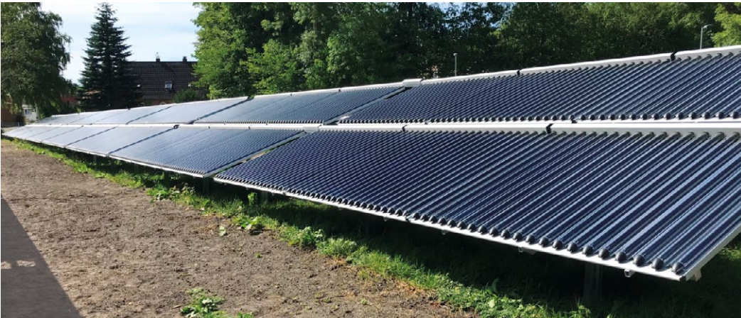
Kollektorfeld mit CPC Vakuumröhren-Kollektoren
