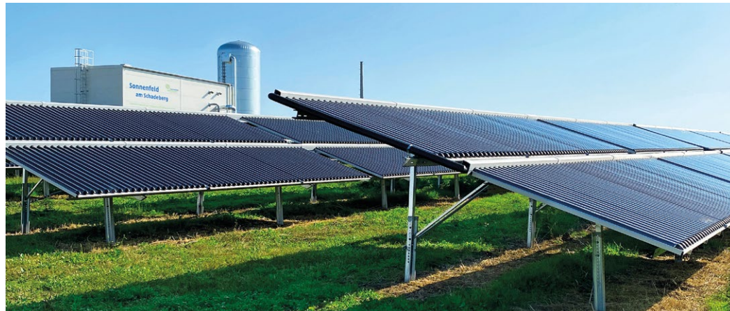
Kollektorfeld mit Wärmeübergabestation im Hintergrund
