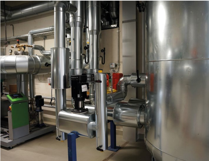
Solarstation mit Stagnationsbehälter
