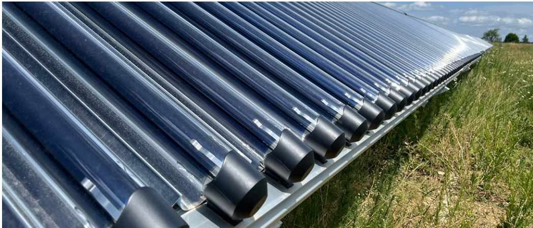
Kollektorfeld mit den neuen Großkollektoren „XXL 19/131“
