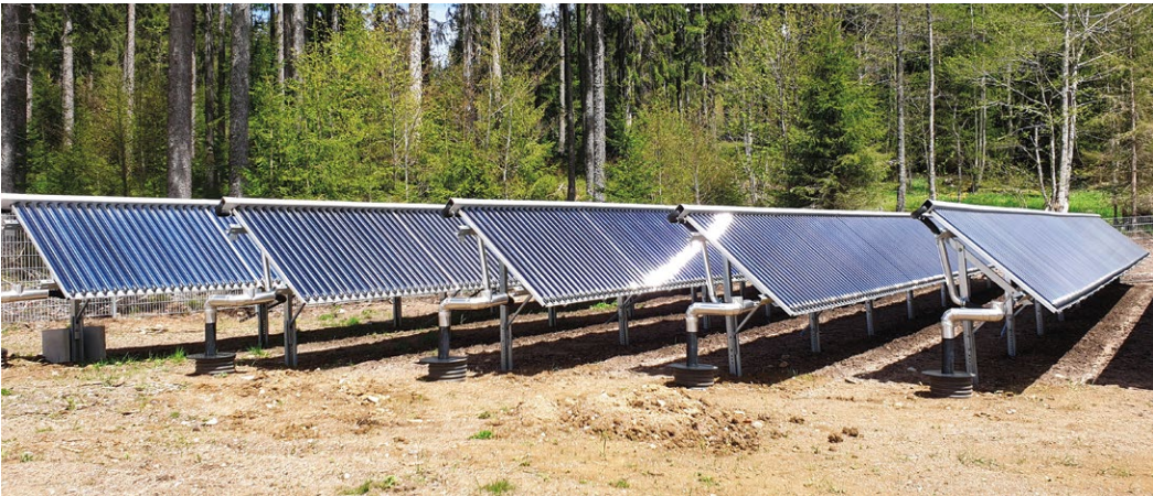
Das Kollektorfeld in Schluchsee
