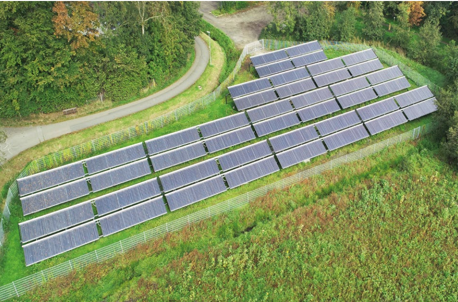
Das Kollektorfeld von oben
