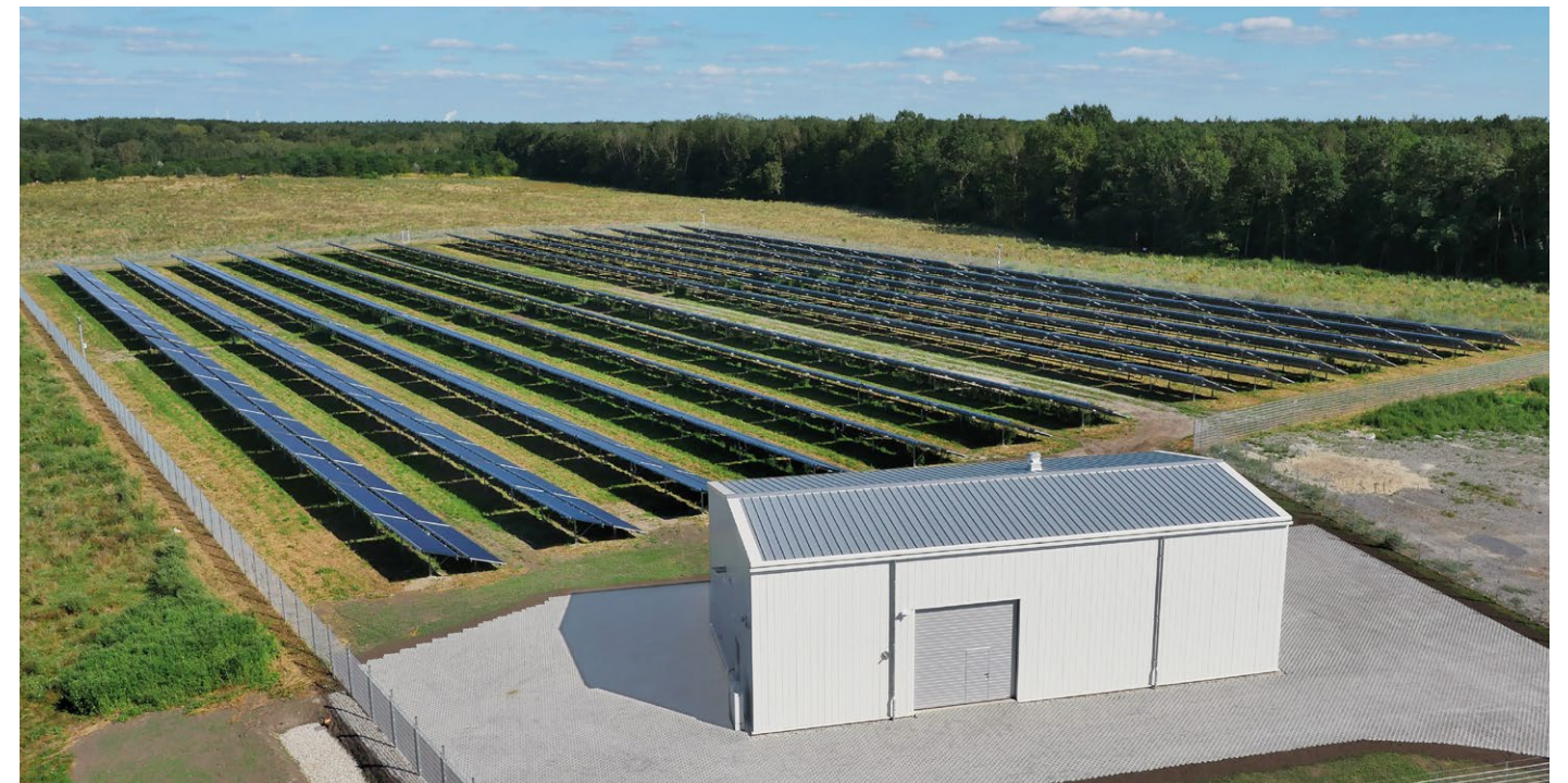
Kollektorfeld mit Fernwärmeübergabestation
