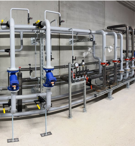
Heizhaus mit Technikzentrale
