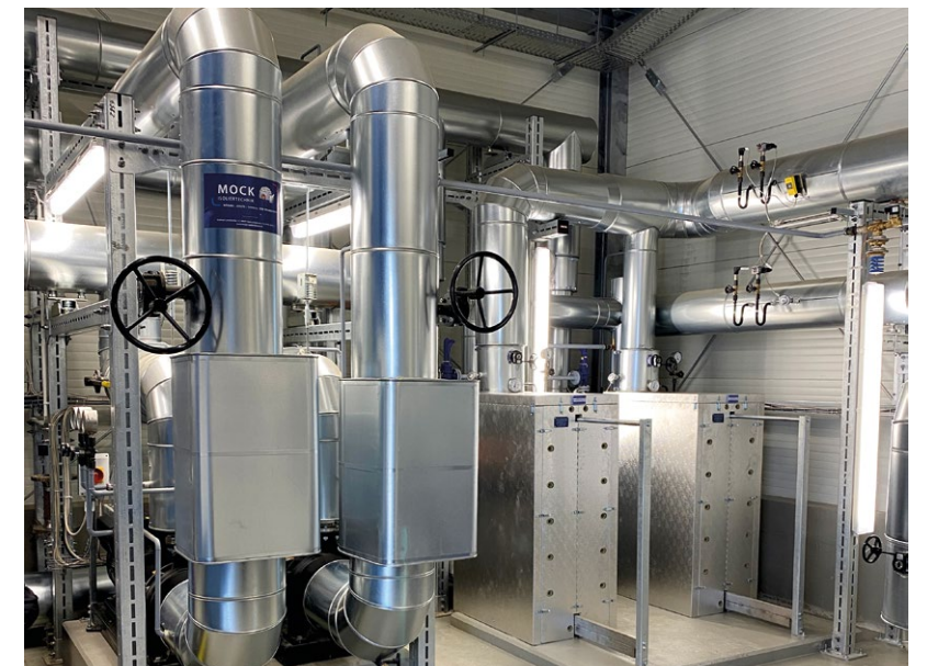
Redundante Wärmeaustauschereinheit für das Fernwärmenetz
