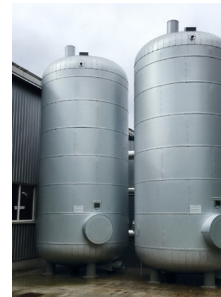
2 x 44 m 3 Pufferspeicher, Außenaufstellung
