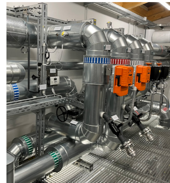
Rohrleitungen und Motorventile in der Solarstation – hier wird die Anlage geregelt und die Wärme ins Netz übertragen
