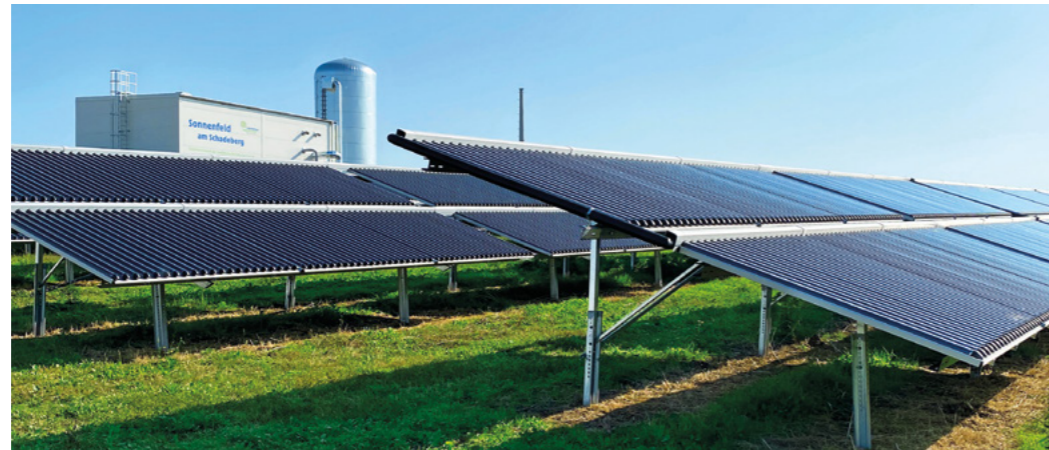
Kollektorfeld mit Wärmeübergabestation im Hintergrund
