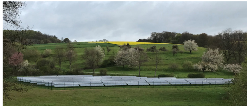
Das Kollektorfeld in Bergheim
