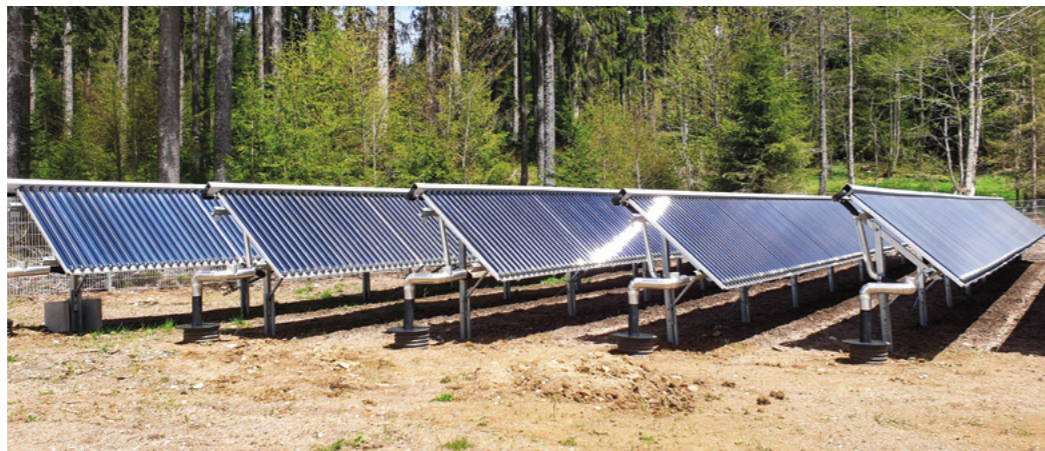
Das Kollektorfeld in Schluchsee
