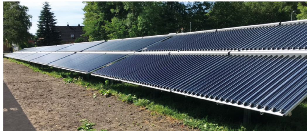
Kollektorfeld mit CPC Vakuumröhren-Kollektoren
