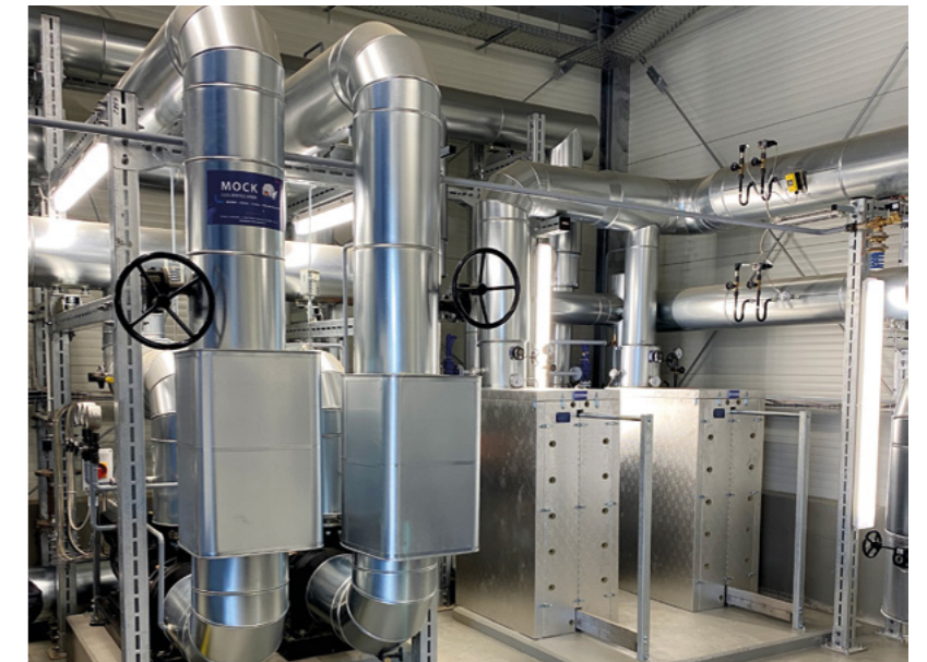
Redundante Wärmeaustauschereinheit für das Fernwärmenetz
