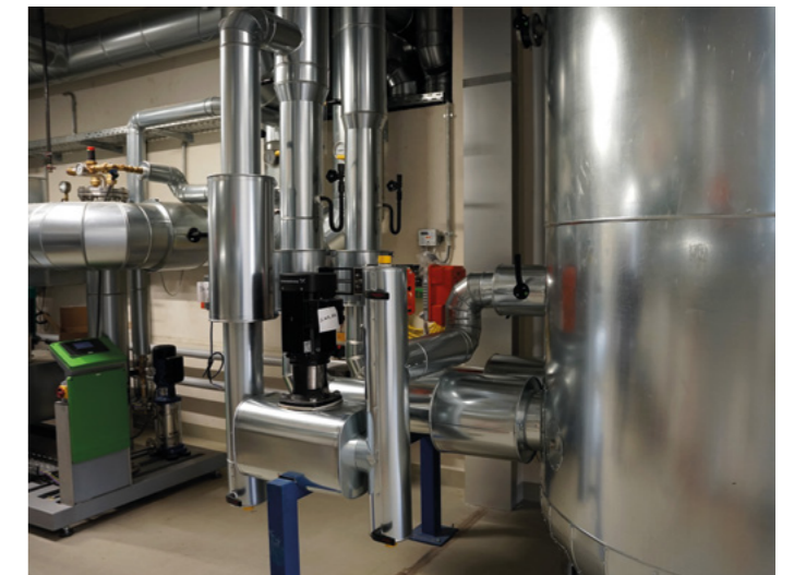
Solarstation mit Stagnationsbehälter
