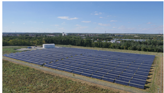
Abb. 14: Kollektorfeld und Wärmeübergabestation (WÜST)
