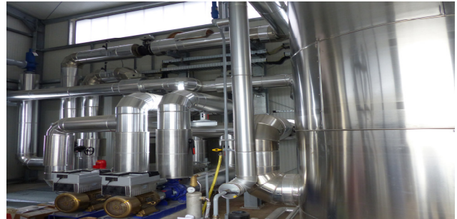
Abb. 13: Die Solarpumpen neben der hydraulischen Weiche
