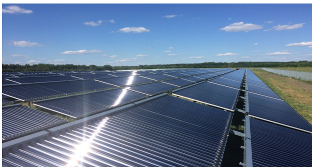
Abb. 1: Das Kollektorfeld in Senftenberg
