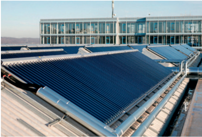
Bild 1b: Vakuumröhren-Kollektorfeld auf dem Sheddach einer Fabrikhalle
