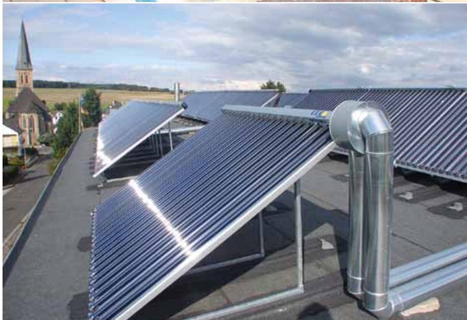
In der „Panorama Sauna“ in Grafschaft Holzweiler sind 98 m 2 CPC-Vakuümrohrenkollektoren installiert.
